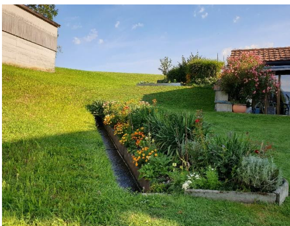
Abbildung 14: Foto offener Rotfarbkanal Bereich Garten
